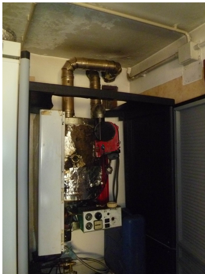
Foto 11 – Stato attuale caldaia a gasolio
