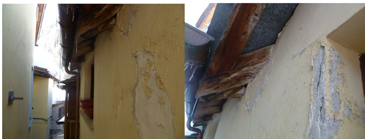
Figura 4- Forte distacco per infiltrazioni
