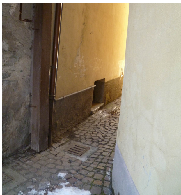
Foto 4 – Porzione bassa prospetto Sud-Ovest (imbrattamento con scritte)
