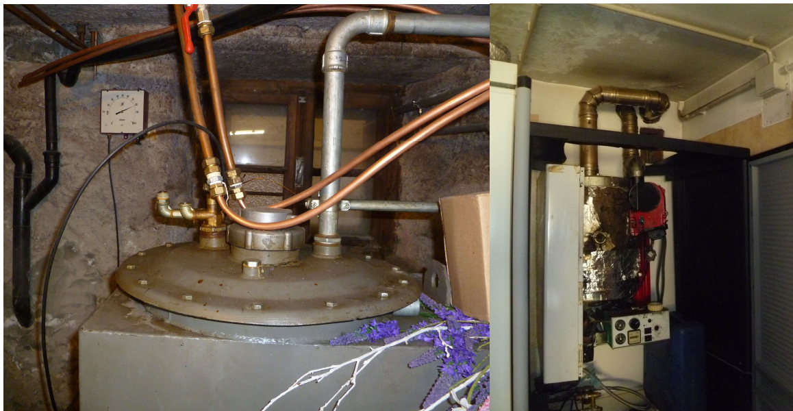
Figura 3- Cisterna di gasolio al piano interrato e caldaia al piano primo
