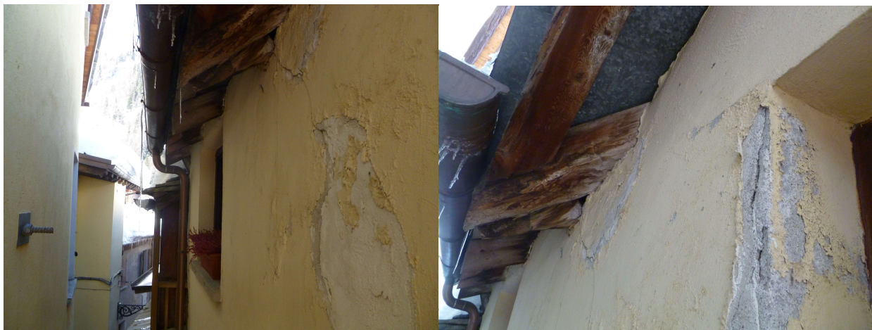
Foto 7 – Stato attuale del distacco in facciata per infiltrazioni
